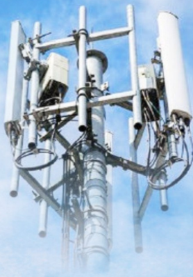
5G网络基站建设，实现 三环内连续高质量覆盖 和远城区重点覆盖
